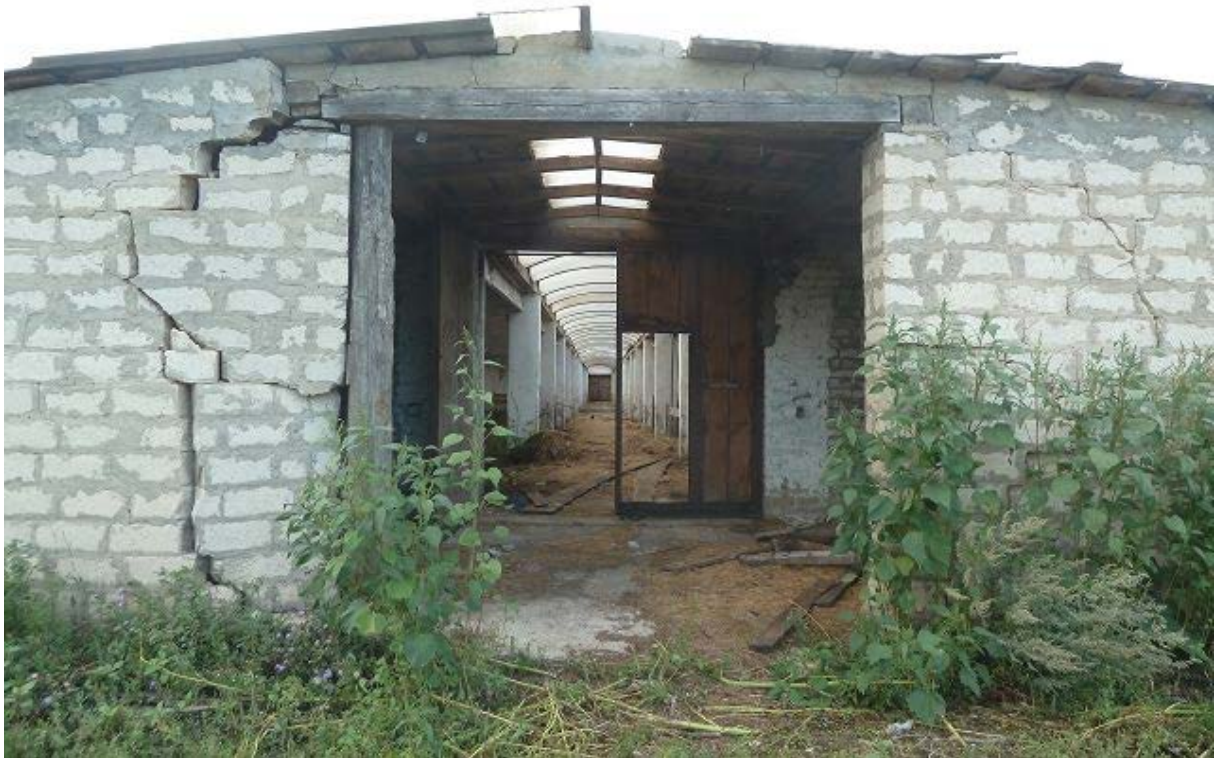
Bild 7: Verfallenes Gebäude – Station Staryy Buyan
